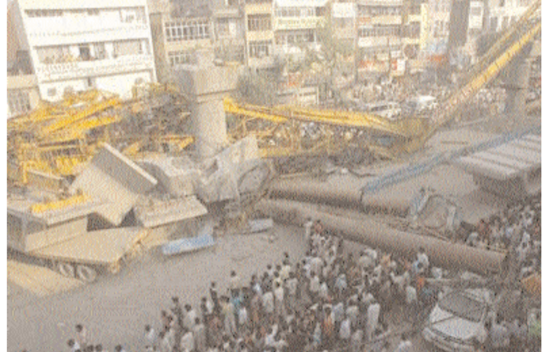
ఆదివారం ఉదయం నిర్మాణ దశలోనే కూలిపోయిన ఢిల్లీ మెట్రో రైల్వేకు చెందిన టైటివర్
